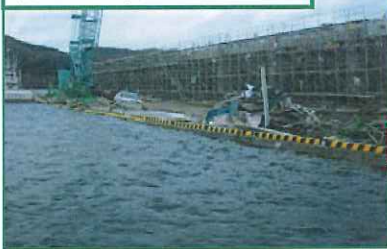
施工前（岸壁の沈下）
